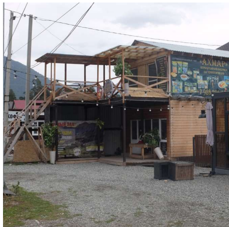
Хаотичные надстройки и выступающие элементы фасадов
